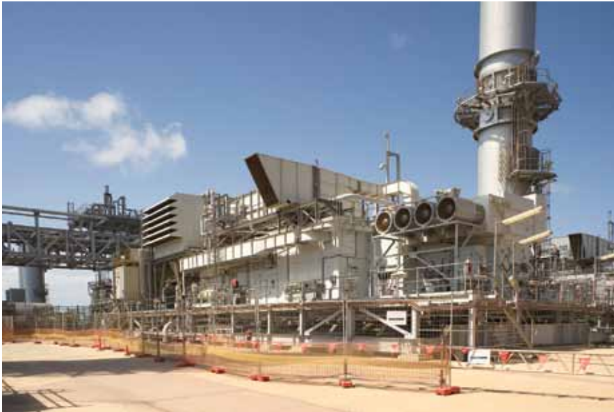
Pluto LNG gas turbine generators.
